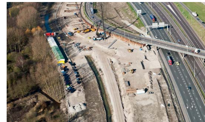
De CX 700 stelling in actie tijdens het heien van de prefab palen voor een van de steunpunten van het nieuwe Oudelandsviaduct. Vlak daarachter is onderaannemer Sterk bezig met het heien van de damwand en daarachter wordt de eerste slag ontgraven zodat het stempelraam aangebracht kan worden.
