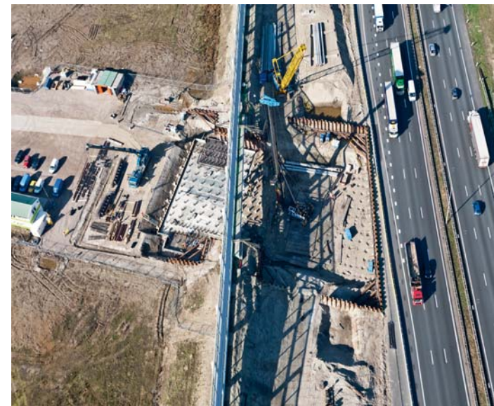
De PM 30 in de deels ontgraven put tussen het geluidsscherm en de huidige rijbaan van de A15. Het scherm langs de rijbaan is onder het weglichaam door, verankerd met horizontaal geboorde ankers.
